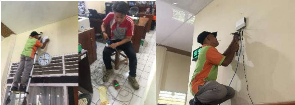
Gambar 32. Pemasangan Access Point sebanyak 2 unit di ruangan administrasi
